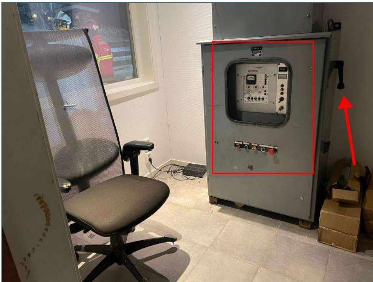
Figur 6: Styringsskapet med hovedbryteren markert med rød pil. Foto og påtegning: Politiet
