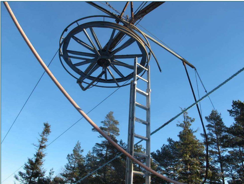
Figur 2: Skiheisens vendehjul på toppstasjonen med stige for å komme til smørepunkt. Foto: SHK
