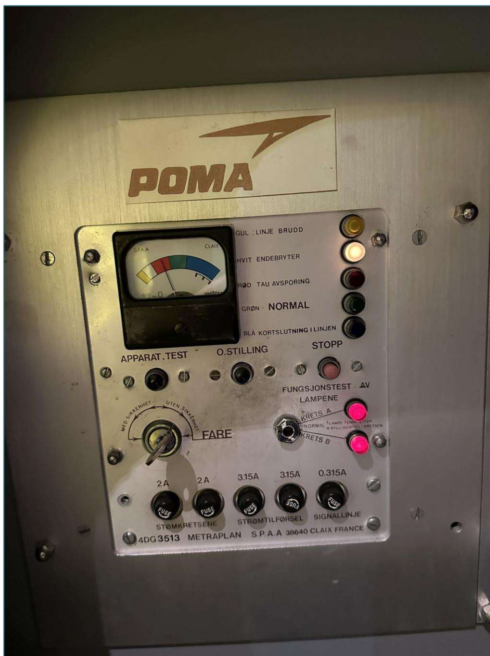
Figur 17: Kontrollpanelet for Hovedheisen slik det framsto etter spenningssetting. Foto: SHK
